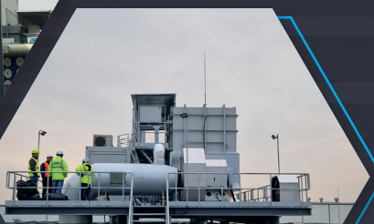
Dopalcz termiczny RTO DRT 25-3, V=25,000 Nm 3 /h, przemysł samochodowy, wielkopolskie
