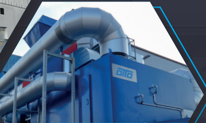
Koncentrator LZO w kombinacji z dopalaczem termicznym RTO 3K, V= 100,000 Nm 3 /h, przemysł energetyczny, śląskie
