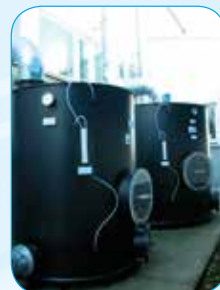
Przemysł lotniczy - Galwanizernia Przepływ powietrza: 7000 m 3 /h Zanieczyszczenia: LZO oraz opary parafiny
